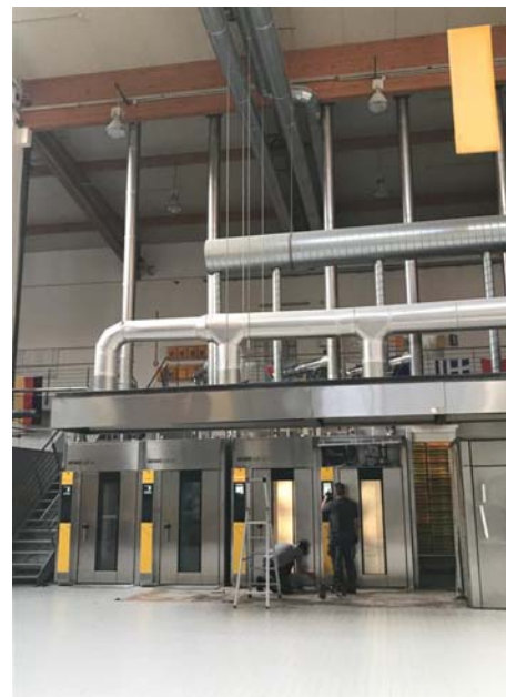
So sehen moderne Großbacköfen heute aus, die von BAELETC bundesweit eingebaut und gewartet werden.
