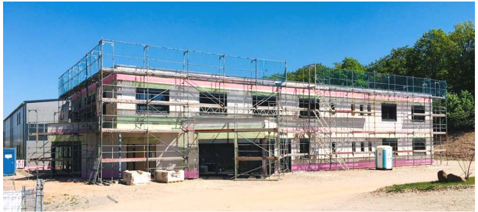
Im Gewerbegebiet Am Nusskopf entsteht derzeit ein Neubau der Firmengruppe, der alle Geschäftsfelder unter einem Dach vereint.
